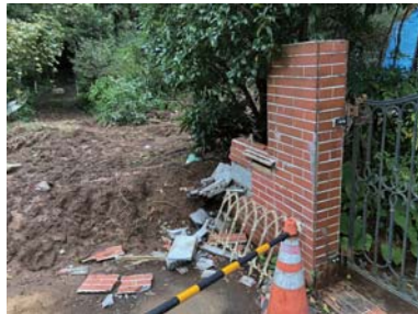
土砂崩れで門やエアコンが被害
