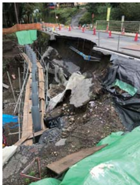
通行止めの吉野街道
